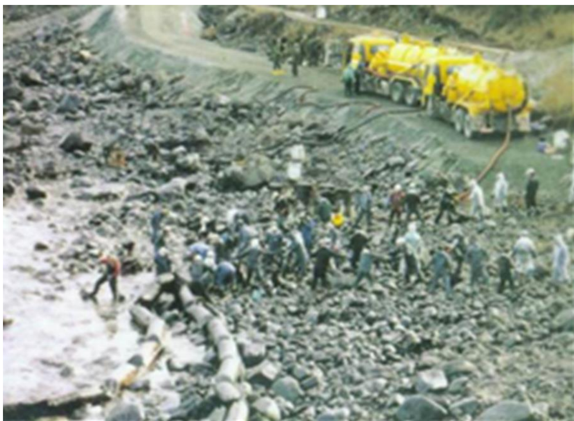
図22 1月13日仮設道路(2号道路)を建設し、漂着油を直接回収するとともに、船首部からの回収に備えた。
